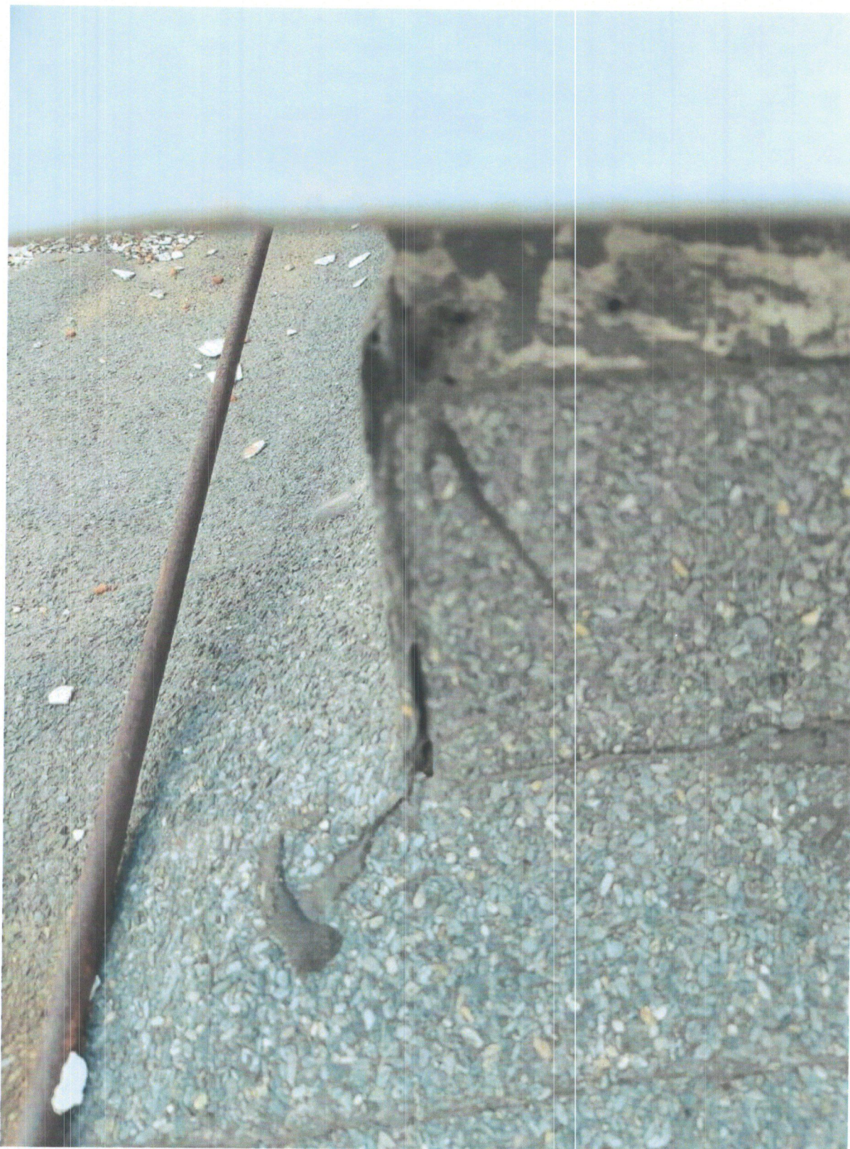
Фото 2 – 5. Разрушение в виде трещин и расслоения швов кровельного ковра в месте примыкания.
